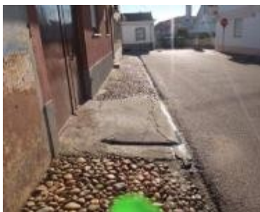
Figura 13 – Pavimentos desadequados e em mau estado de conservação
